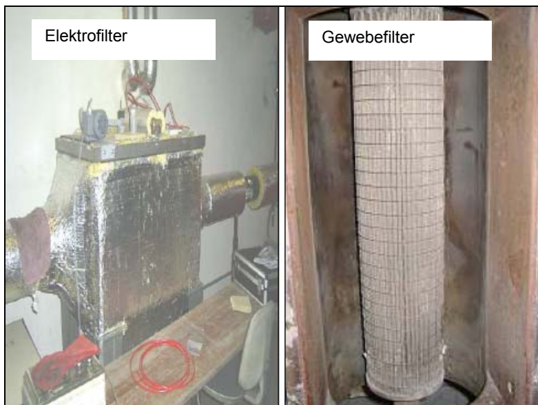
Abbildung 68: Filtertechnik zur Rauchgasreinigung 269
