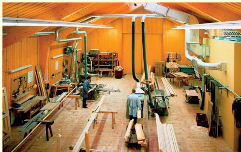
Beleuchtung einer Möbeltischlerei mit Reflektorleuchten für Leuchtstofflampen
